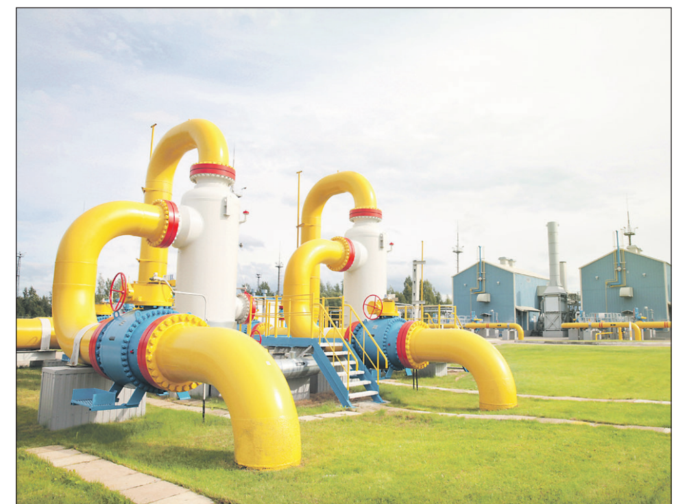
Компрессорная станция «Северная»
